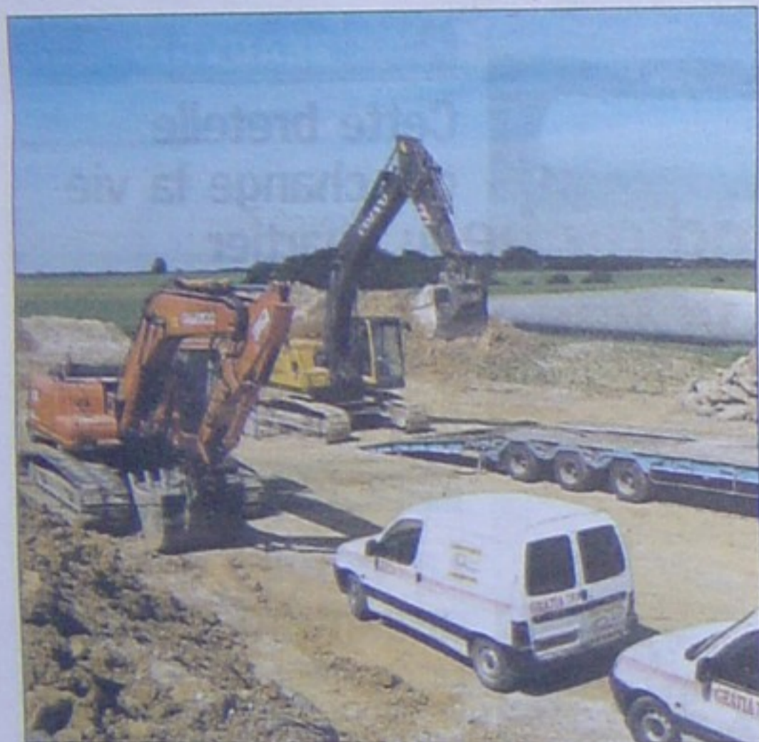
HETOMESNIL, ROUTE DE CONTEVILLE. VENDREDI. Impressionnant, le chantier vient de débuter. Les pales de la première éolienne oisienne sont posées dans le champ. (L.P./P.C.)
